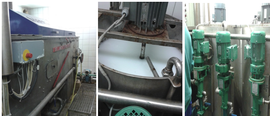
Abbildung 3-4: Maschinelle Schlammeindickung mittels Siebband und Dosierung von Flockungshilfsmitteln
