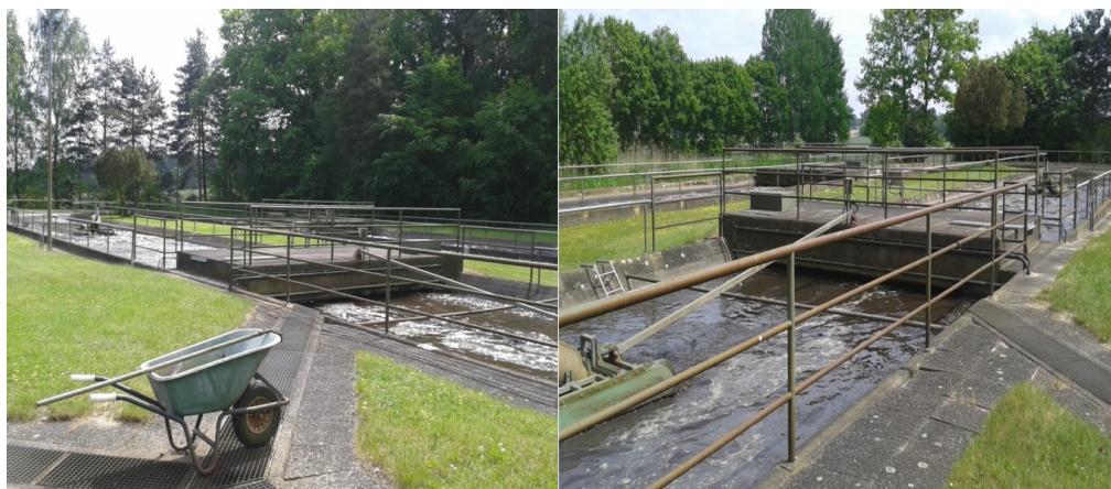
Abbildung 3-3: Mammutrotoren der Kläranlage Bienenbüttel auf den Umlaufgräben
